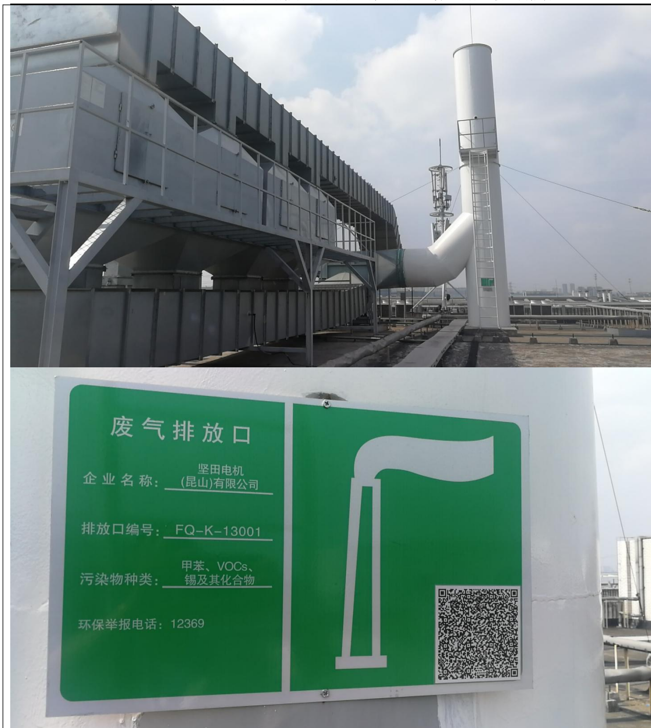
图 3-4 二号排气筒及废气治理设施
